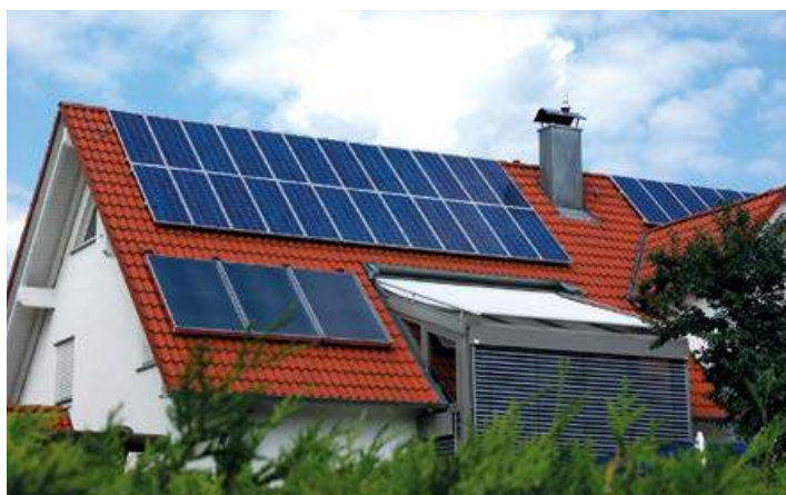
Umwandlung von Sonnenenergie in Strom (oben) und Wärme (unten) auf einem Hausdach
